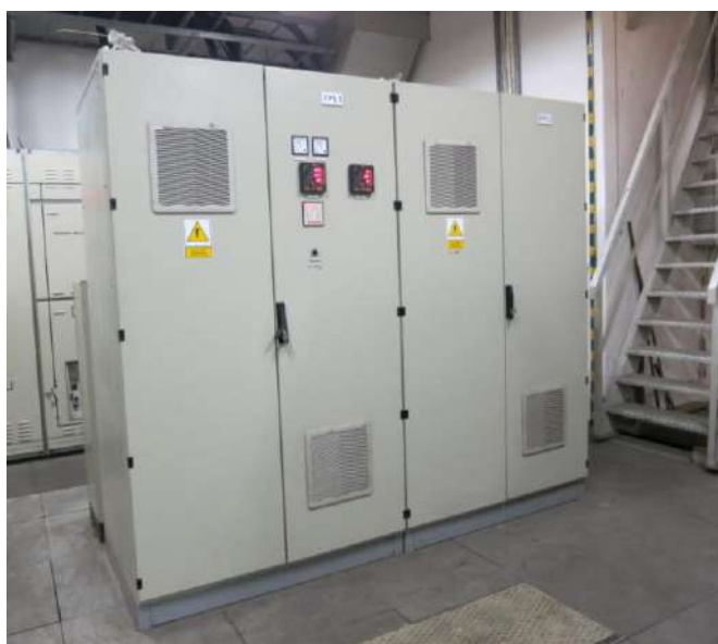
Rys.3. Widok przemysłowego filtra pasywnego harmonicznych h5 i h7, zainstalowanego w sieci nN zakładu przemysłowego
