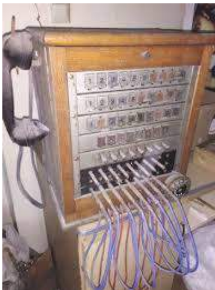
Fot.7. Przykład ręcznej centrali telefonicznej
