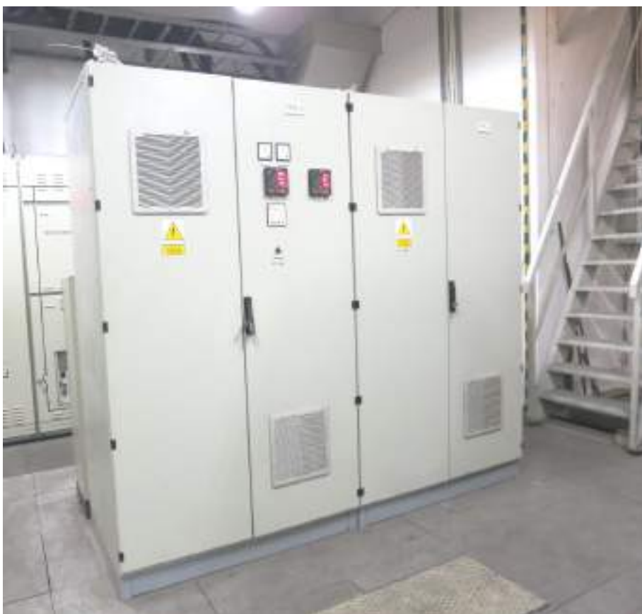
Rys.10. Widok przemysłowego filtra pasywnego harmonicznych h_5 i h_7 , zainstalowanego w sieci nN zakładu przemysłowego
