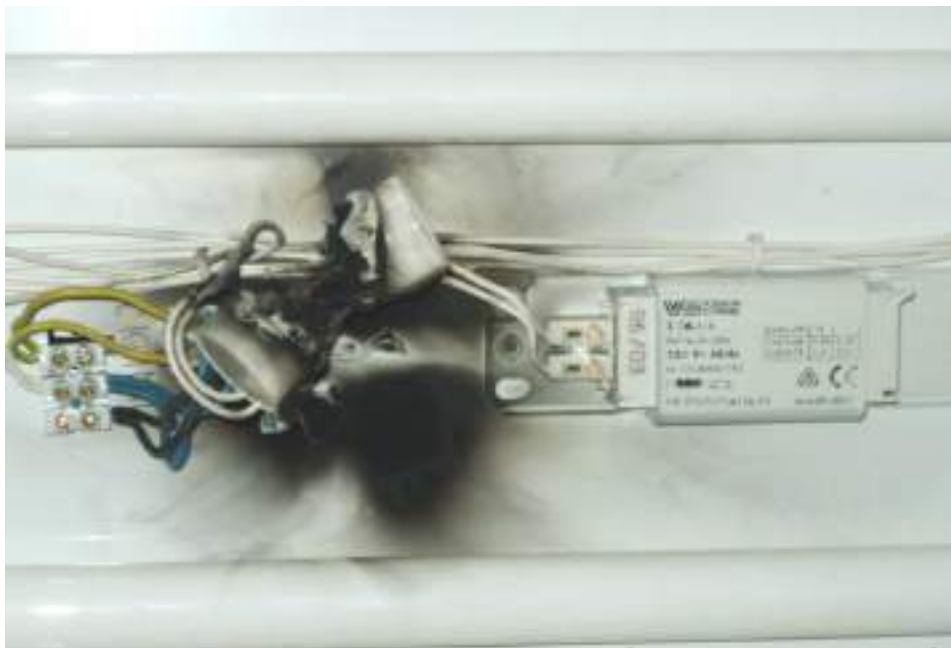
Rys.4. Skutki eksplozji kondensatorów mających kompensować składową bierną prądów opraw oświetleniowych
