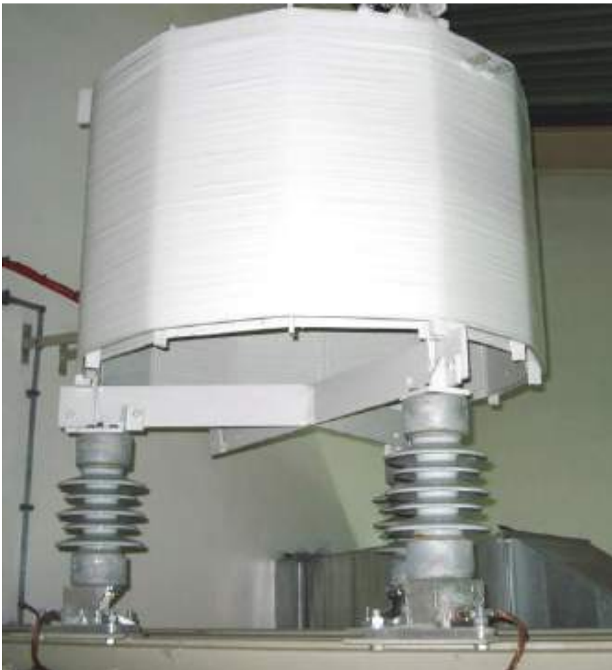
Rys.9. Dławik powietrzny filtru pasywnego zbudowanego do sieci SN o napięciu 15 kV
