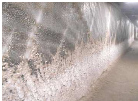
Fot.13. Wykwity soli na ścianach korytarzy
