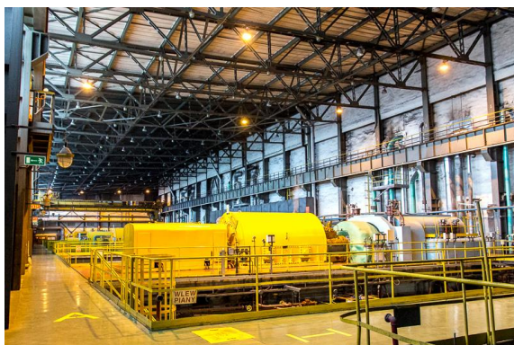
Fot.2. Hala generatorów energii elektrycznej
