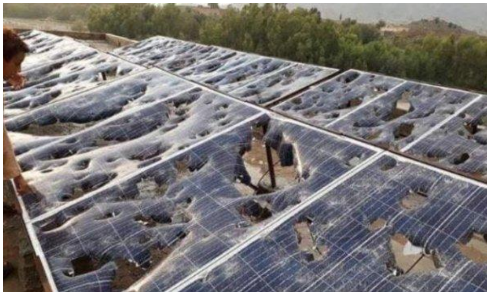
Fot.1. Panele fotowoltaiczne po gradobiciu
