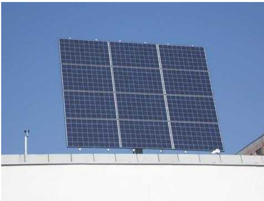
Rys. 3. Panele na trackerze (PV3), źródło: elektrownia.pb.edu.pl
